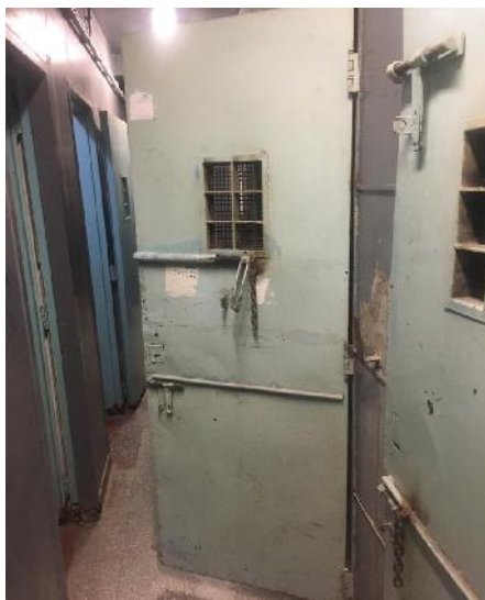
Puertas de las celdas deterioradas
